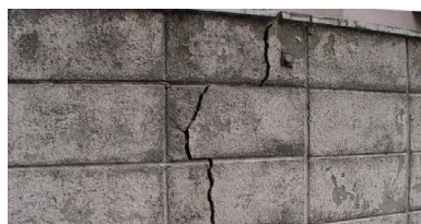
危険なブロック塀の例
