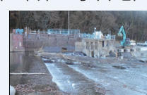
承元寺取水口
